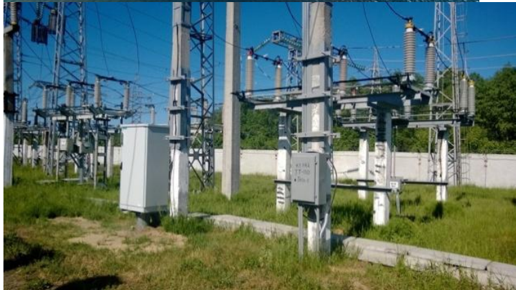
ПС 220 кВ Венец
